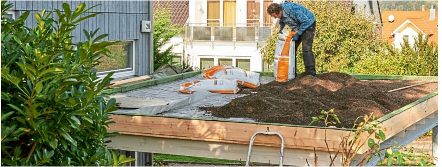
Mehr Grün in der Stadt: Auch kleinere Dachflächen wie auf Carports lassen sich bei überschaubarem Aufwand relativ einfach nachträglich bepflanzen und somit verschönern.
